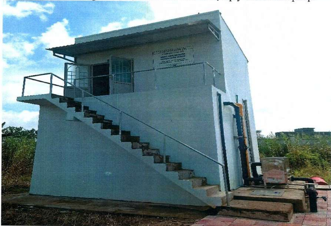
Hình 2. Hệ thống xử lý nước thải Trung tâm y tế huyện Châu Thành
